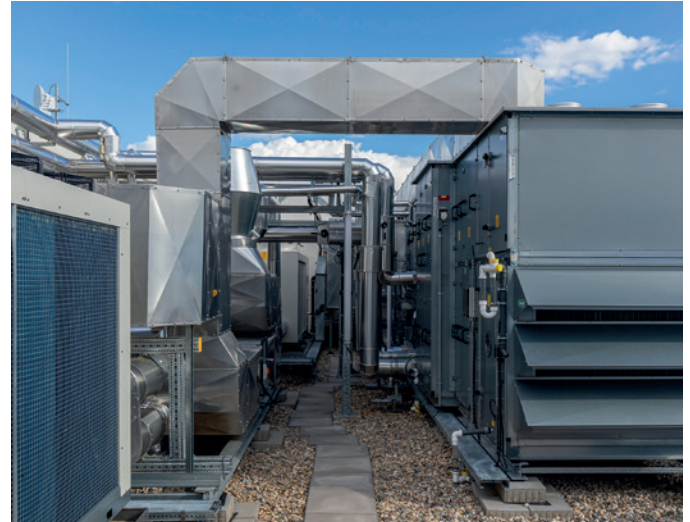
Technik auf dem Dach
